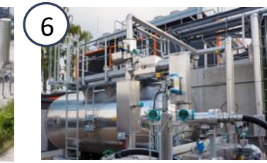
Versorgung Fischer-Tropsch SAF-Anlage (Atmosfair)
