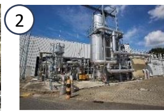
Aminwäsche (nach Biogas-Anlage)
